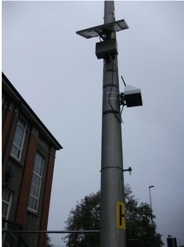
Ffigur 15 – Llun o Diwb Tryledu a Monitor AQMesh y tu allan i Ysgol Pentip
